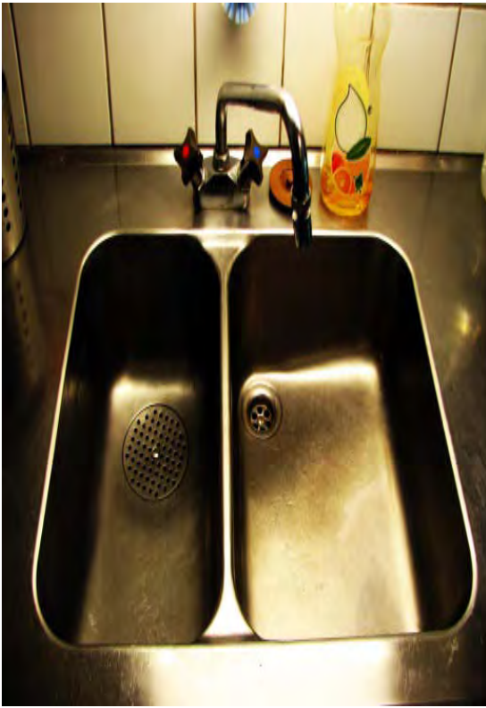
Água canalizada dentro de casa
