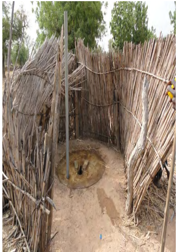
latrina com laje não ventilada
