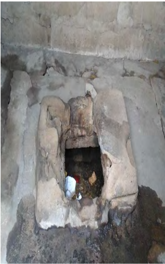
latrina com laje não ventilada
